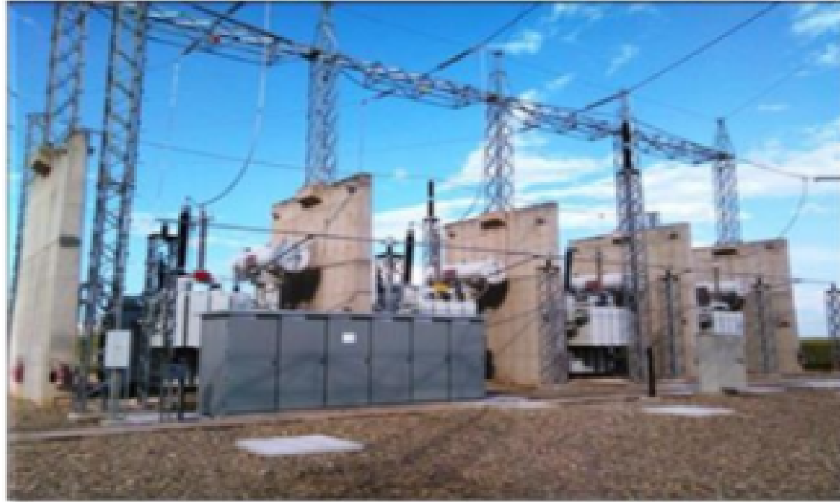
Autotransformadores trifásicos 230-115 KV SE Quifa
