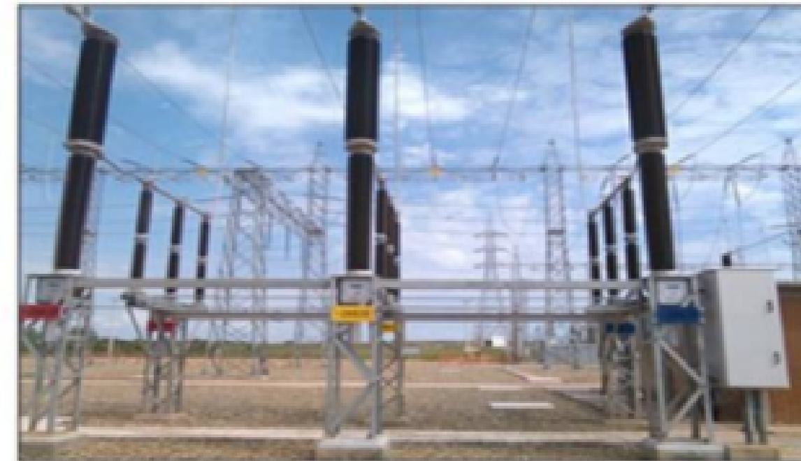
Interruptor mando tripolar Patio 230 KV SE Quifa
