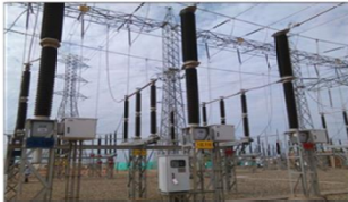
Interruptor mando monopolar Patio 230 KV SE Quifa
