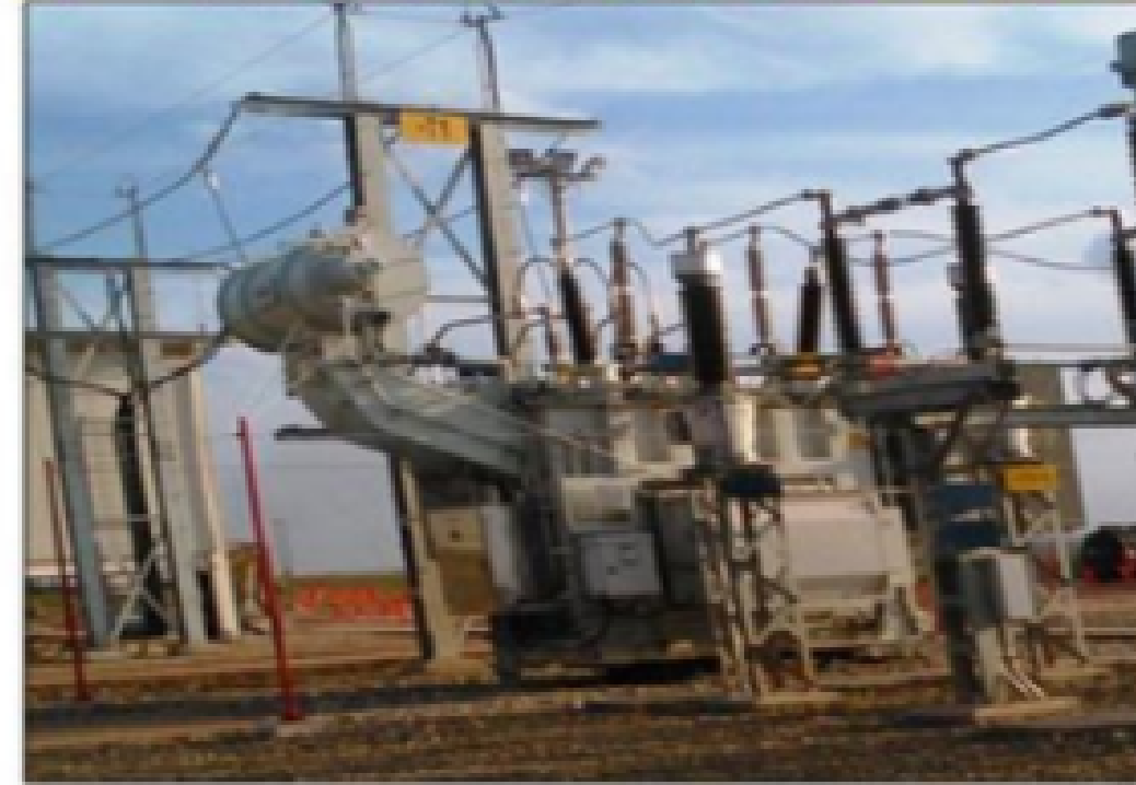
trifásicos 115-34,5 KV SE Quifa
